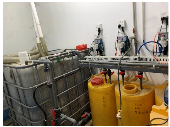
废水处理设施
