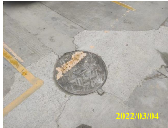
项目车间外污水井盖
